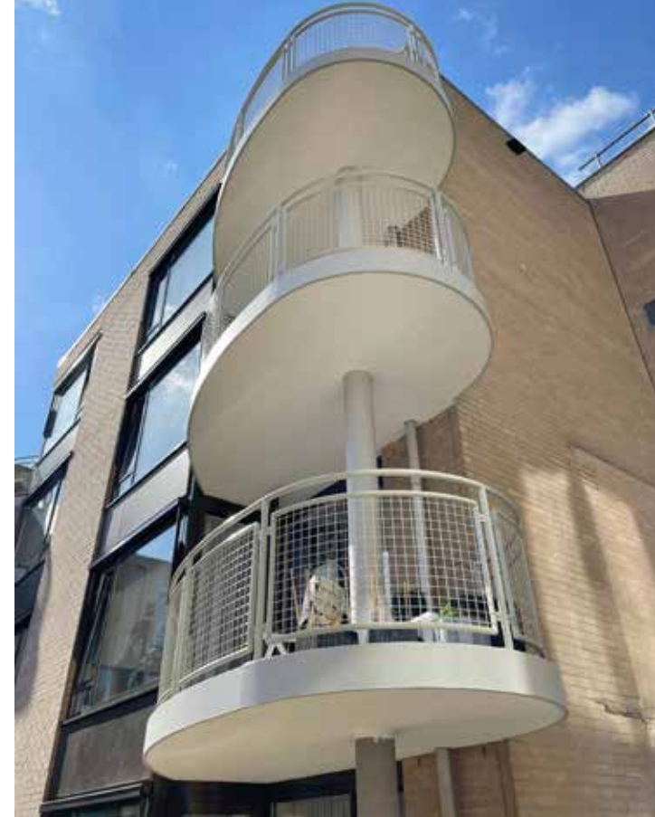
De plafonds, de aanzichten en de hekwerken van de balkons kregen een nieuwe laag verf, waardoor de gevel opfleurt.
